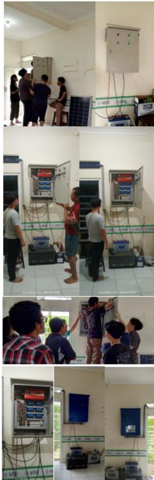
Gambar 3: Panel kontrol dan inverter 2kVA yang diimplementasikan
