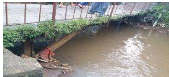
Gambar 2. Bagian bawah jembatan penyebrangan Cawang eksisting
