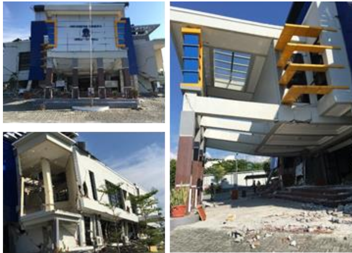
Gambar 1 Kondisi setelah gempa Bangunan Universitas Terbuka Palu (Sumber Pribadi)
